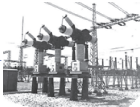
1960-1980 г. Воздушные выключатели ВВН
