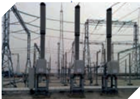
2014 г. Элегазовые колонковые выключатели ВГП 220м на напряжение 220кВ
