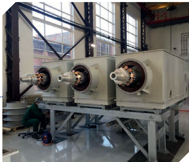
2012 г. Элегазовое генераторное распределительное устройство КАГ-20
