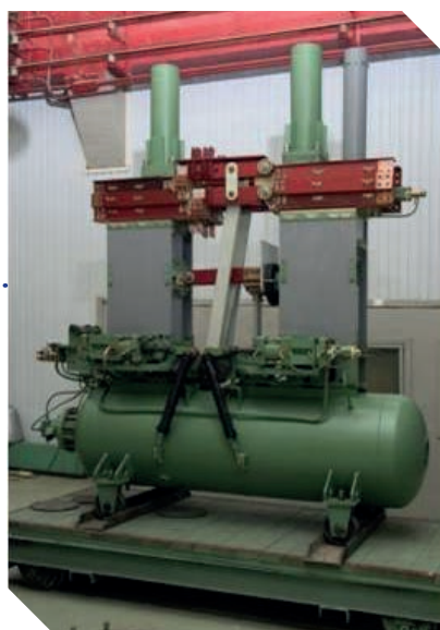
1975 г. Воздушные выключатели ВВГ
